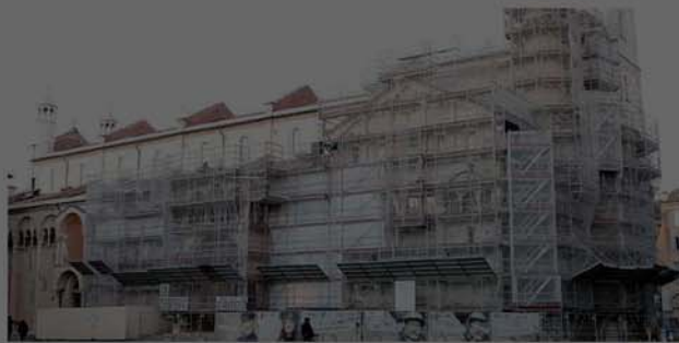
Le impalcature per i lavori di restauro della Cattedrale, a giorni saranno rimosse
